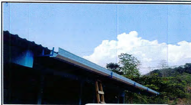
Foto 2: se observa la instalación del canal y bajada del agua pluvial del establecimiento.
